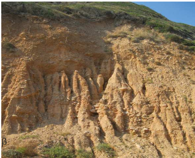
Φ.15 Άποψη παραλιακού τμήματος Μουρτερής, χαμηλή ακτή και προβλήματα θαλάσσιας διάβρωσης στο πρηνές κατόντη (α) και ανάντη (β) του παραλιακού δρόμου(σκόπευση προς Β και Δ αντίστοιχα)
